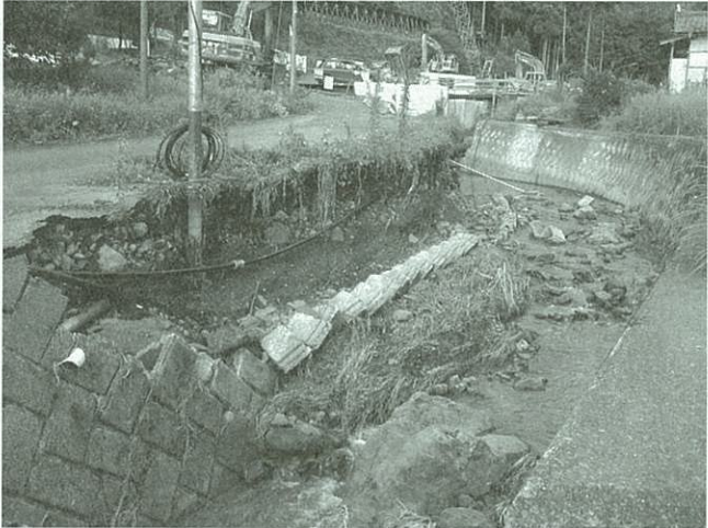
神宮川上流の護岸が崩壊しました
